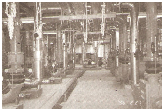
รูปที่ 25 ภายในห้องเครื่องทำน้ำเย็น
