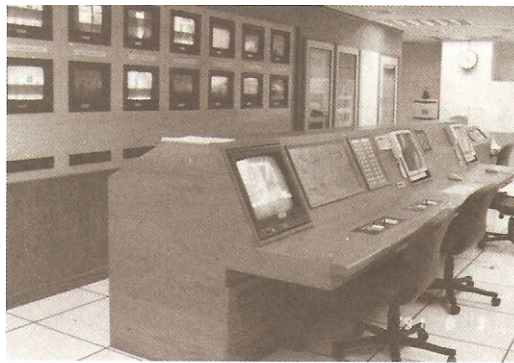
รูปแสดงห้องระบบรักษาความปลอดภัย
