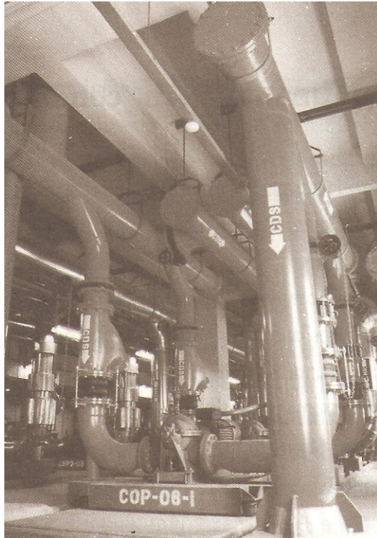
รูปที่ 16 เครื่องสูบน้ำระบายความร้อน
