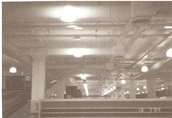
รูปที่ 17 ท่อลมแบบ SPIRAL
