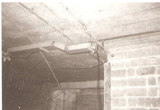
รูปแสดงการ OBSTRUCT ระหว่างรางเดินสายไฟกับแนวสปริงเกอร์
