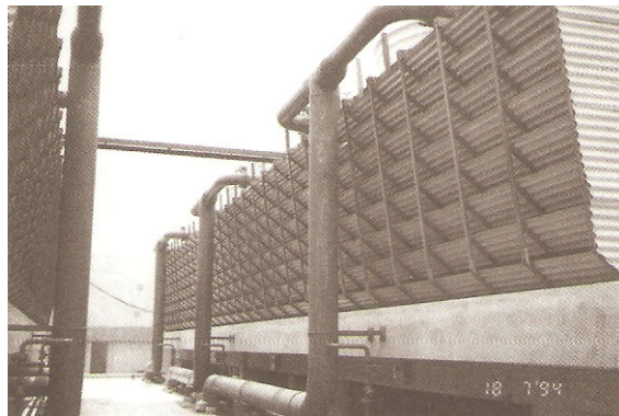
รูปที่ 28 หอระบายความร้อน
