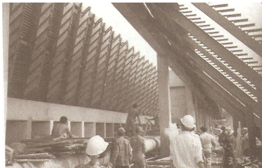
รูปที่ 30 หอบายความร้อน
