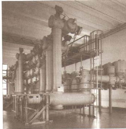
รูปที่ 3 INDOOR SUBSTATION
