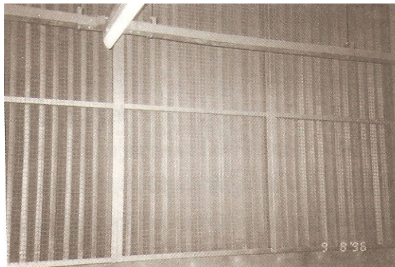
รูปงานติดตั้งแสดง Sound Attenuator
