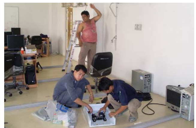
รง.เครื่องไฟฟ้า กฟฟ.ชย.ทร. เดินระบบไฟฟ้าให้กับ ยศ.ทร.
